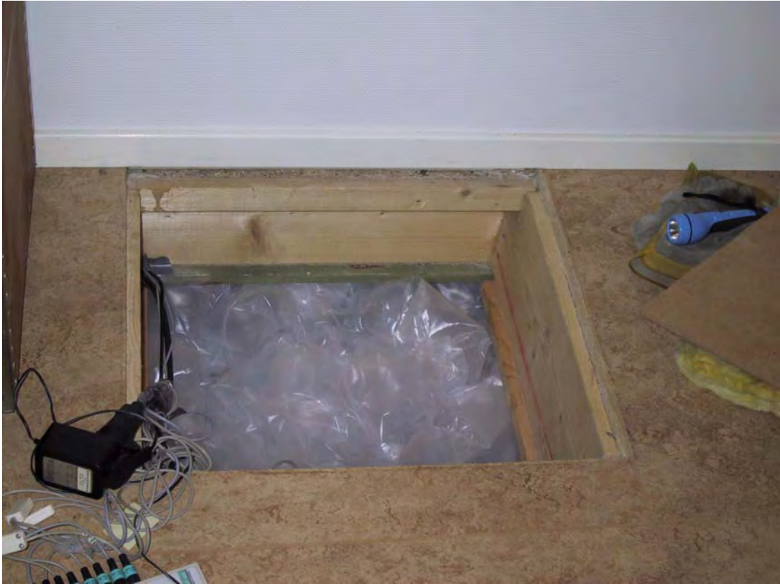
Efter installationen, inspektionssluckan
